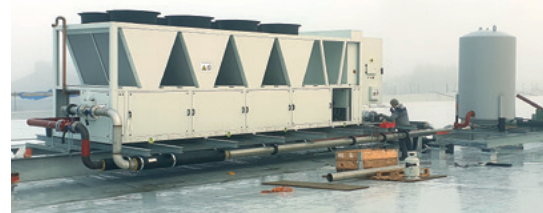
Chiller op het platte dak
